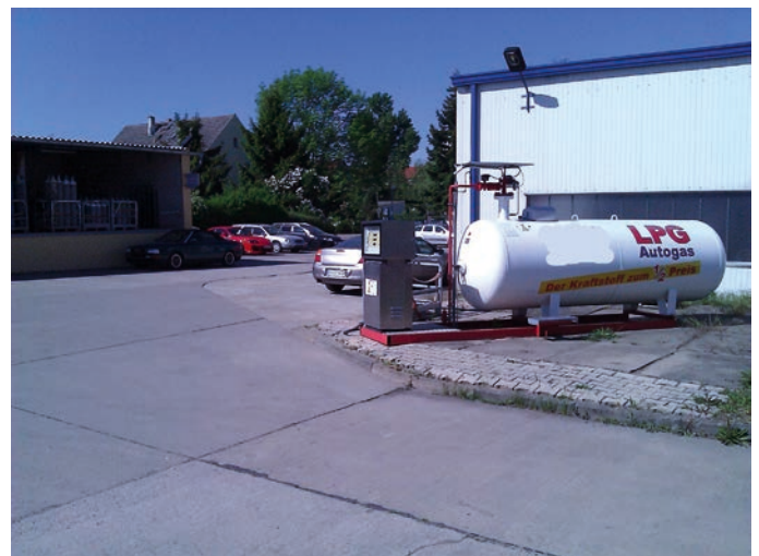
Abb. 1 Beispiel für einen unzureichenden Anfahrerschutz
