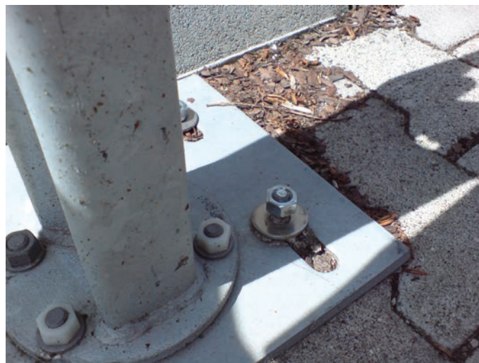
Abb. 4 ungenügende Verankerung der Leitplanke
